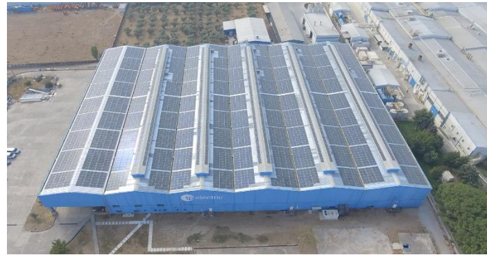
TP ELEKTRİK ÇATI GES DC GÜÇ: 1.482 kWp
